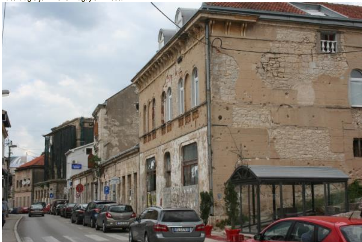
Beschadigde huizen door oorlogsgeweld
